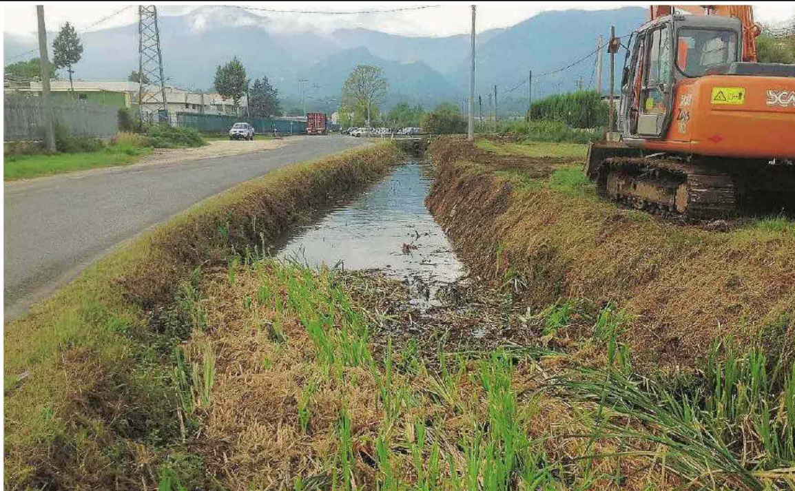
Uno dei numerosi lavori che il Consorzio di Bonifica sta eseguendo lungo canali e fossi di sua competenza
