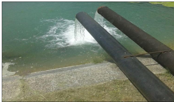
Vasca "Tufano" scarico dell'attingimento dai pozzi
