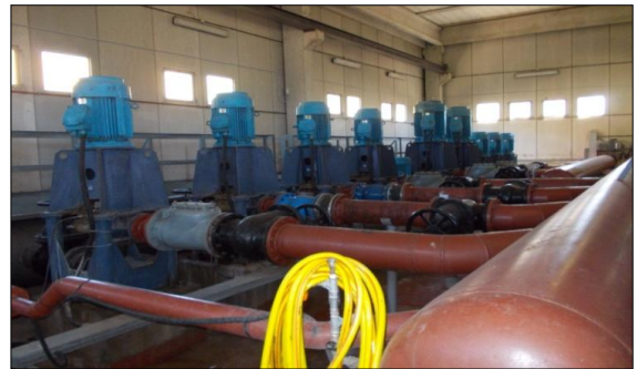
Centrale di sollevamento: locale pompe
